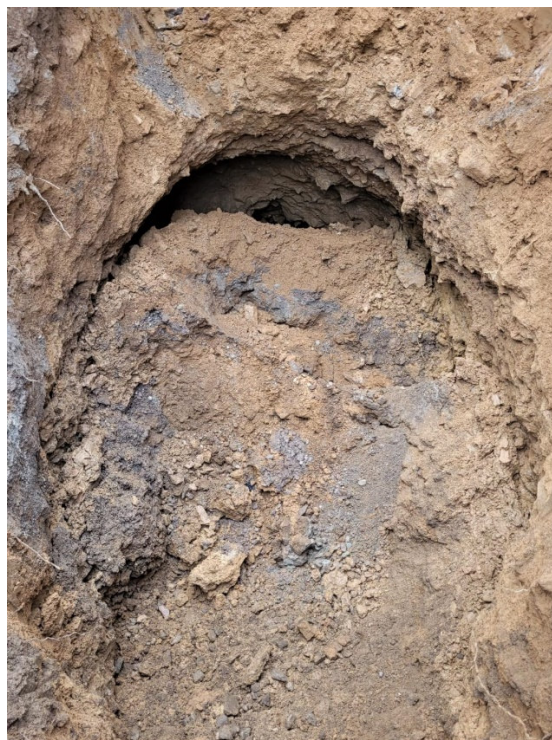
Der Zugang zum „Luftschutzstollen“ war verschüttet.
