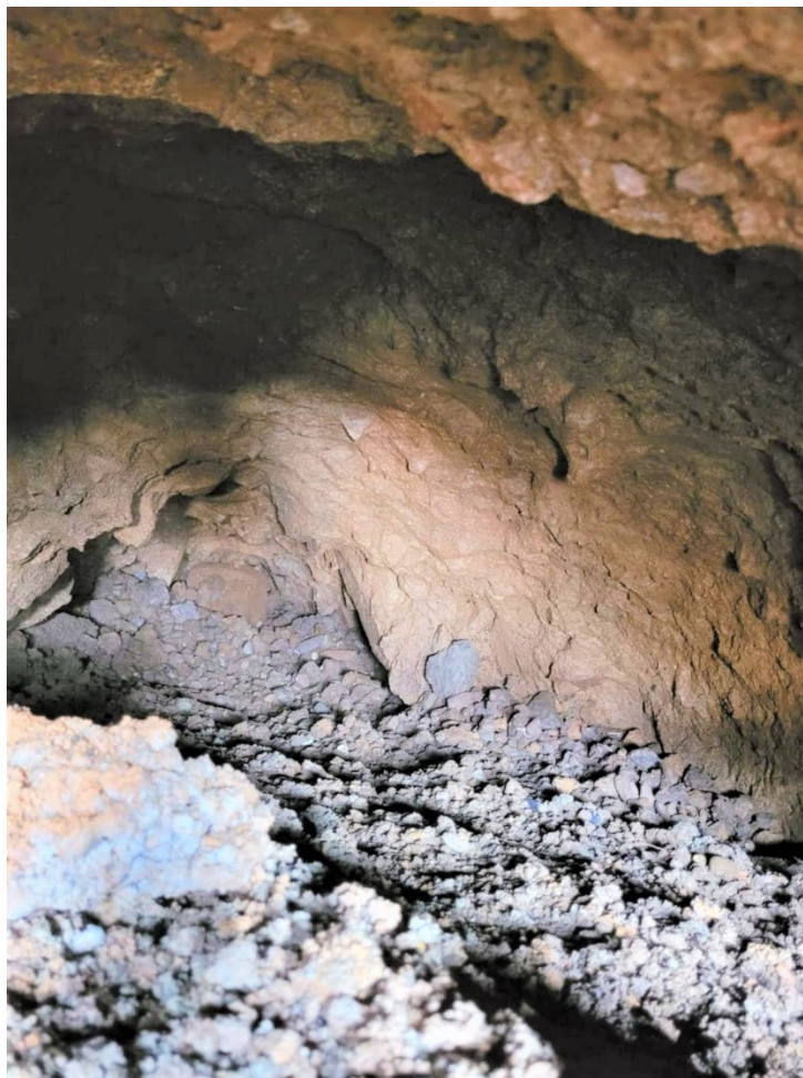
Mitte April tat sich unter der Staigstraße ein großer Hohlraum auf.
